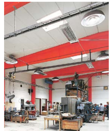
Mit IR-Wärmestrahlern kann die Temperatur in unterschiedlichen Raumbereichen perfekt angepasst werden. Punktuelleres Heizen erhöht den Komfort und verringert die Heizkosten.
